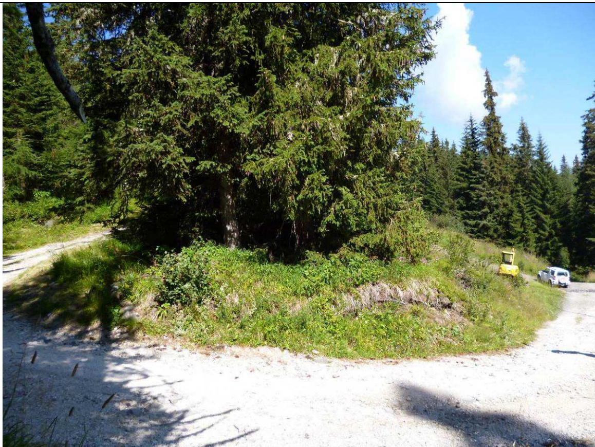
Foto 17 - Tornante 6 - Il tornante possiede dimensioni idonee al passaggio degli autocarri ma necessita della stabilizzazione definitiva del fondo della carreggiata, spesso erosa dalle acque.
