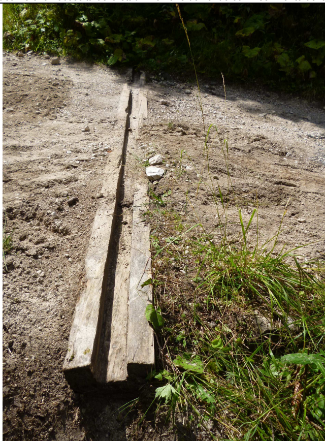
Foto 20 - La carreggiata attuale è dotata di canalette in legno ormai deteriorate in quanto marce, logorate e/o sfasciate dal passaggio dei trattori. In queste condizioni la canaletta perde la sua funzione e diviene onerosa da mantenere. Si opta per la sostituzione di tutte le canalette in legno con quelle in cls armato preconfezionate e con quelle metalliche.
