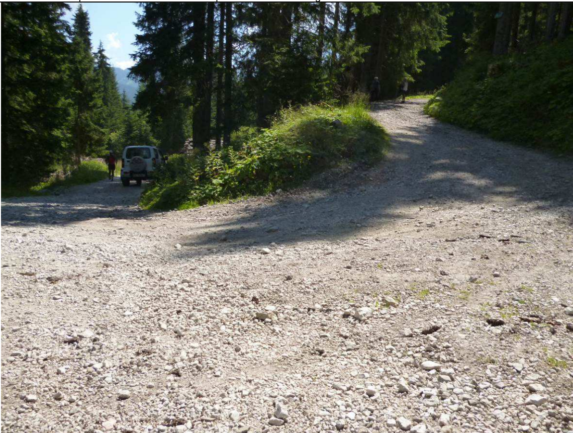
Foto 2 - Tornante 1. L'attuale raggio di curvatura a centro carreggiata è pari a 5 m. Lo slittamento dei pneumatici dei trattori e degli autocarri nel percorrere la curva, causa la continua erosione e il dissesto del fondo della carreggiata.
