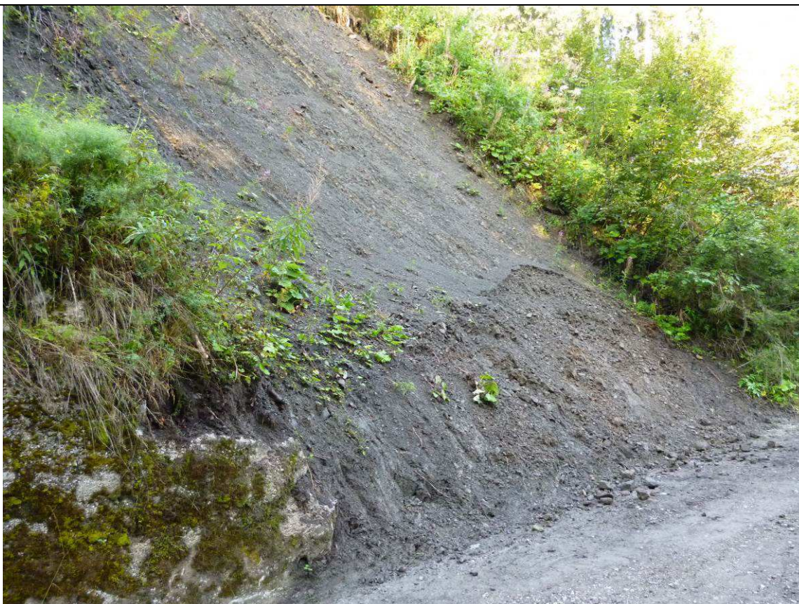
Foto 1 - Sez. 3-4. Poco a monte del Ponte sul Rio Code, un tratto di una decina di metri di scarpata di monte continua a cedere in corrispondenza dell'interruzione del muro di contenimento in calcestruzzo. Si opta per l'erezione di una scogliera a secco in massi ciclopici e per la stabilizzazione della scarpata a monte della scogliera e del muro mediante stesura di stuoia.
