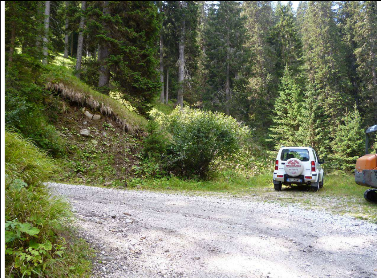
Foto 14 - Tornante 5. La scarpata di monte si presenta già dissestata, sicché l'intervento consentirà di porre definitivo rimedio al problema.
