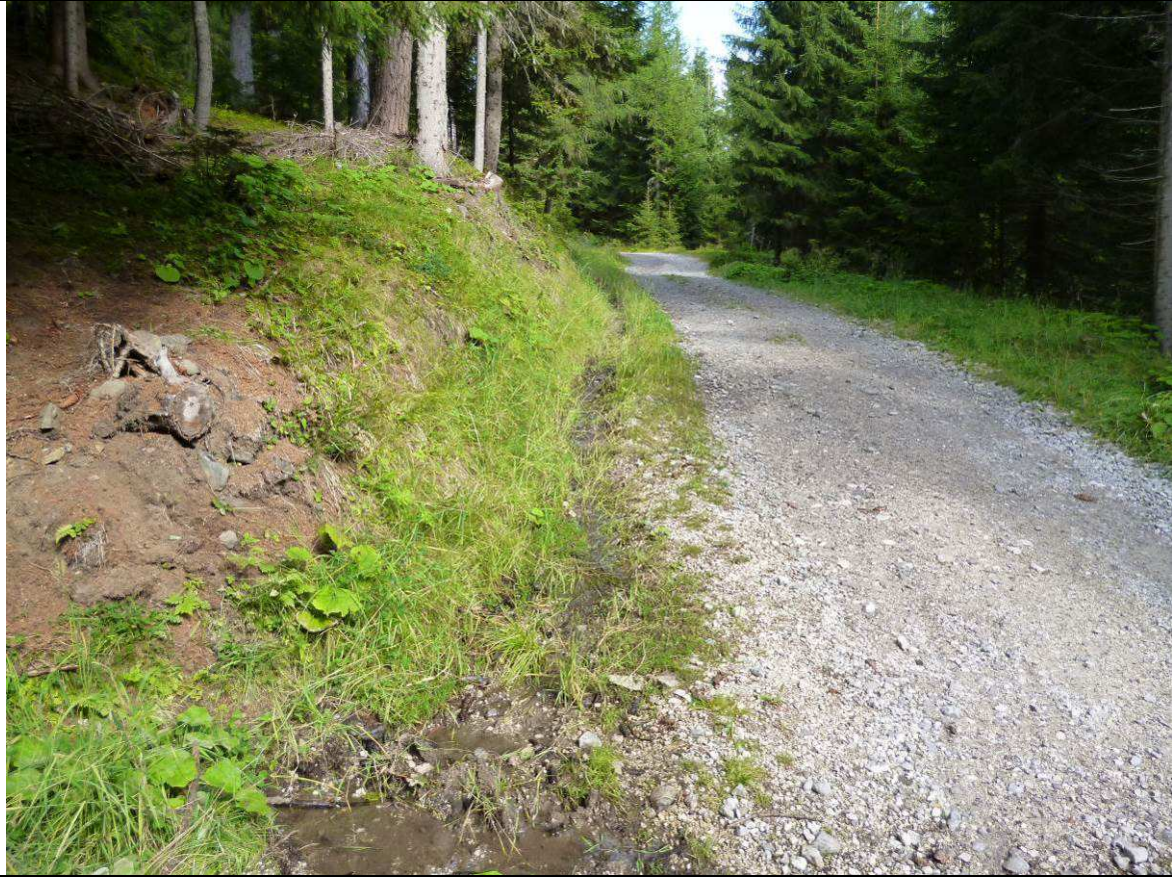
Foto 7 - Trincea drenante necessaria tra i tornanti 2 e 3.
