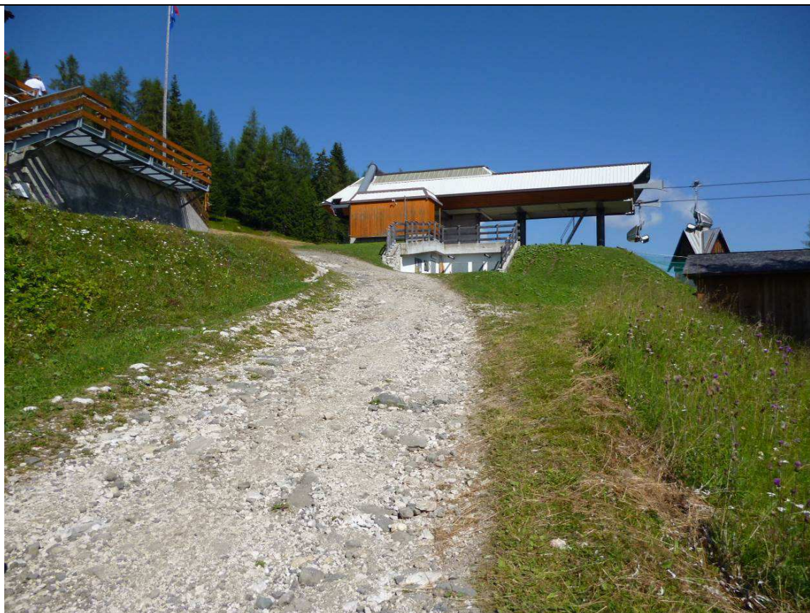
Foto 19 - Ultimo tratto acclive che necessita della stabilizzazione del fondo con inserimento delle canalette caccia-acqua.
